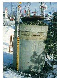
写真-1 マンホールの浮き上がり (H5 釧路沖地震) 1)
