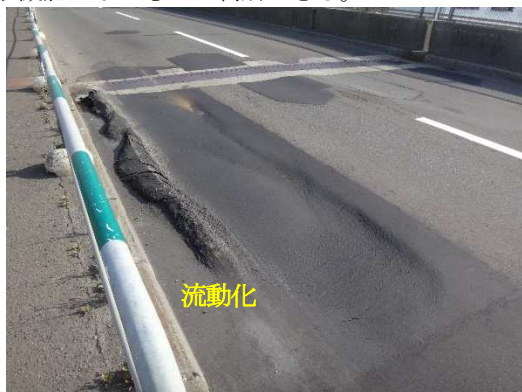
写真-2 舗装流動化状況
